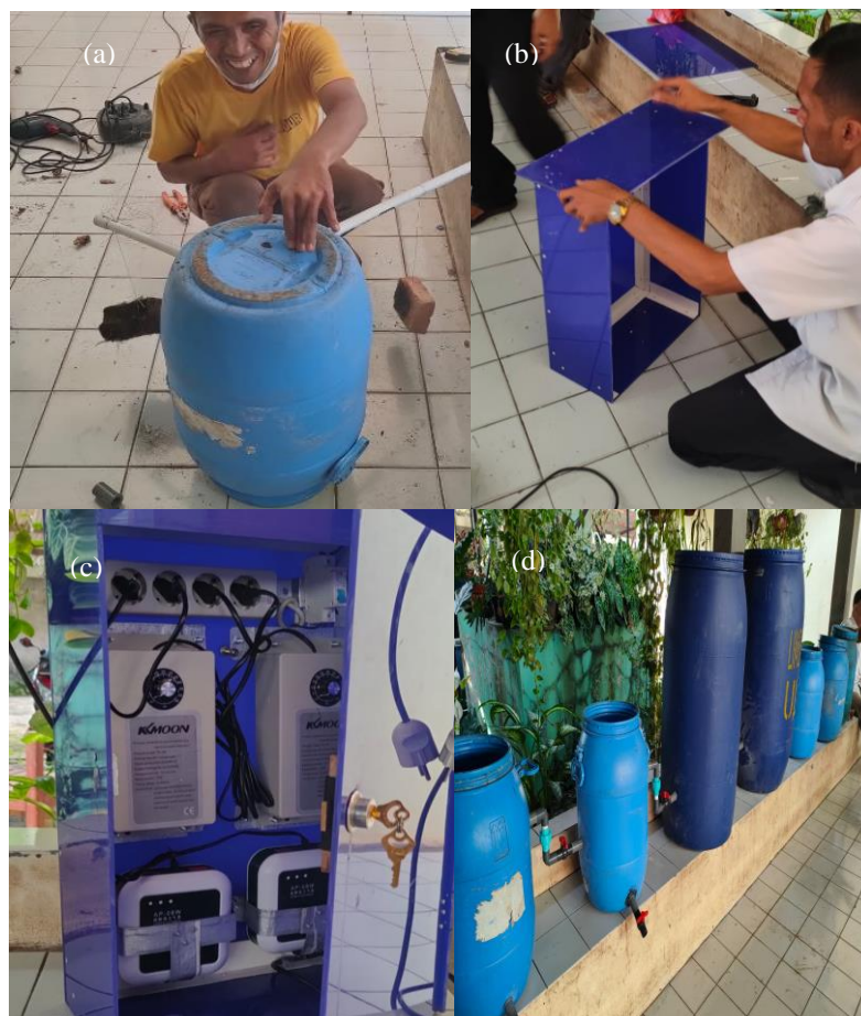
Gambar 2. Proses Pembuatan Bak IPAL: (a) Pembuatan Lubang, (b) Pembuatan Panel, (c) Rangkaian Ozonizer dan Aerator, (d) Rangkaian Bak IPAL
